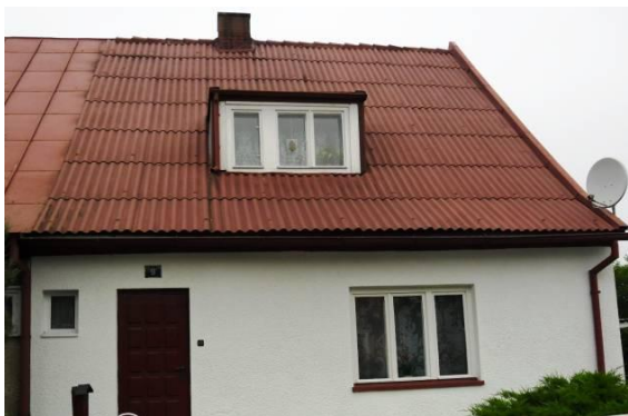
Rys. 6. Pokrycie dachowe ocenione w III stopniu pilności (źródło własne).
