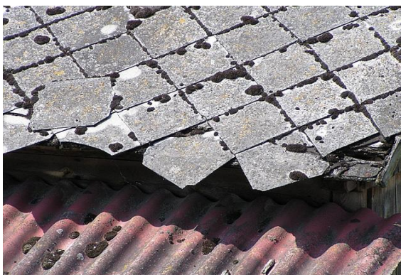
Rys. 8. Pokrycie dachowe ocenione w I stopniu pilności (źródło własne).
