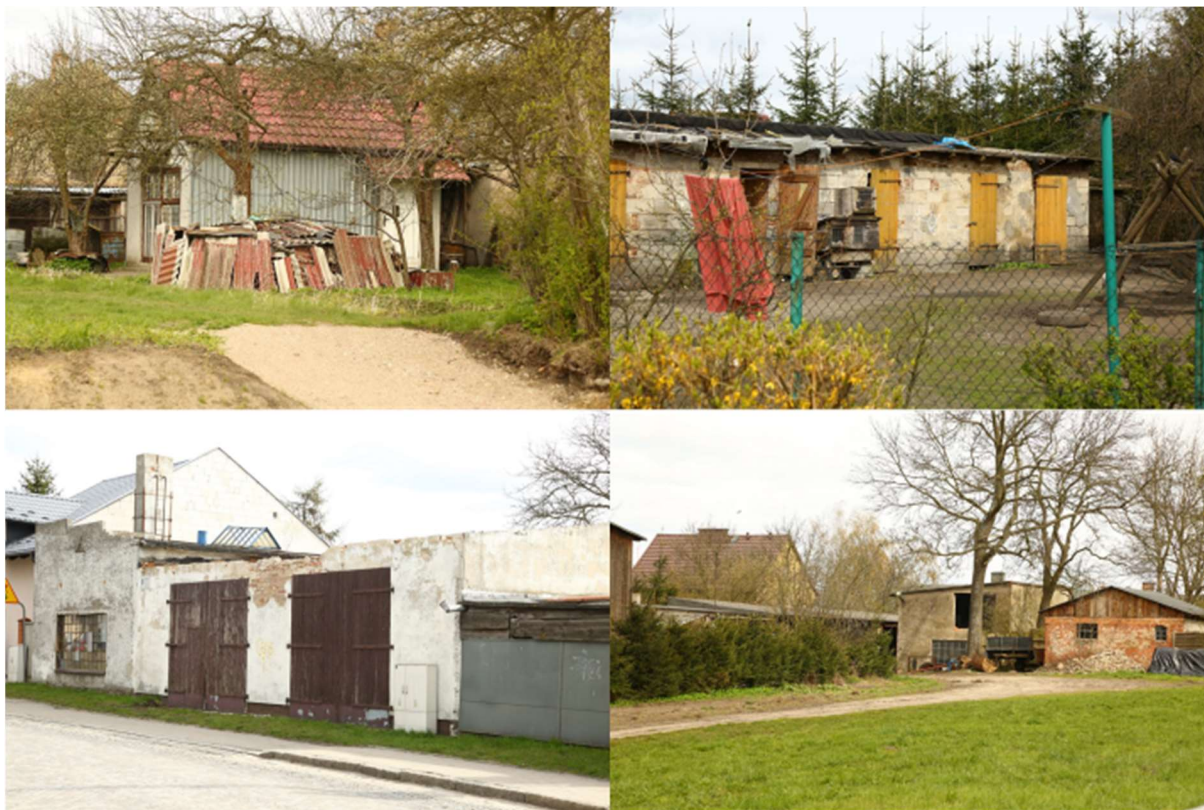
RYSUNEK 36. DOKUMENTACJA FOTOGRAFICZNA - STAN BUDYNKÓW GOSPODARCZYCH
